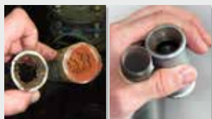
Sistema de tuberías
