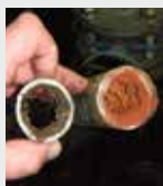
Sistema de tuberías
