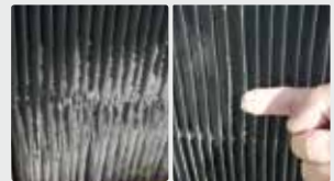
Rejillas de torres de refrigeración
