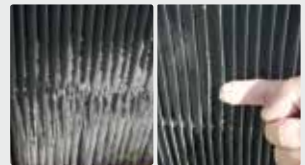
Rejillas de torres de refrigeración
