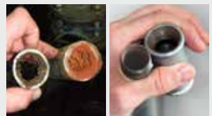
Sistema de tuberías
