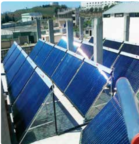
Paneles de energía solar en un edificio de apartamentos.
