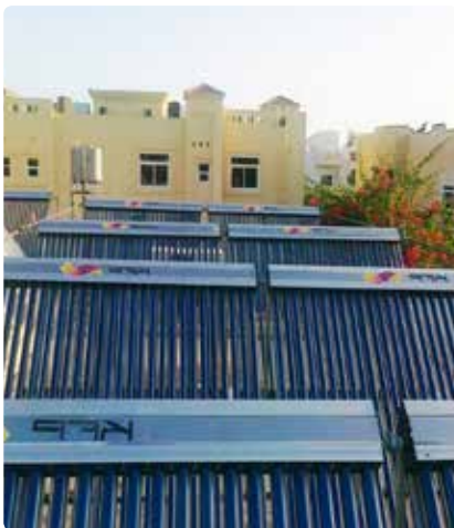
Sistema energía solar térmica.
