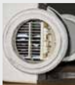
Filtro de la piscina
