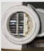
Filtro de la piscina
