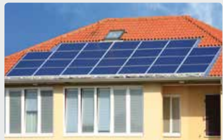
Paneles de energía solar en una vivienda particular.
