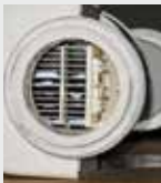
Filtro de la piscina
