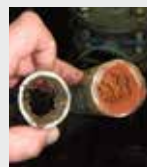
Sistema de tuberías
