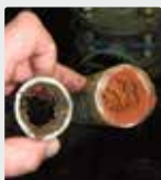
Sistema de tuberías
