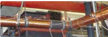
Vulcan S250 instalado en el Hospital St. Joseph
