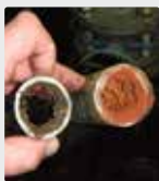
Sistema de tuberías
