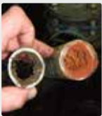
Sistema de tuberías
