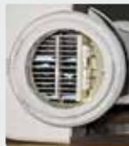
Filtro de piscina
