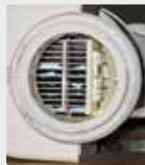
Filtro de piscina
