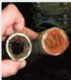
Sistema de tuberías
