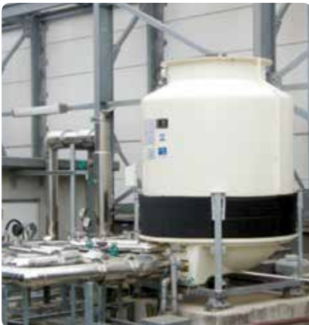
Tour de refroidissement
