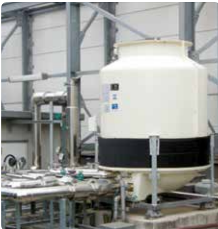
Torre de refrigeración
