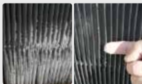
Rejillas de torres de refrigeración
