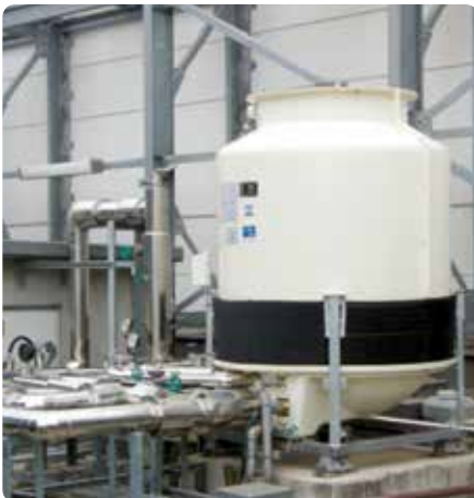
Torre de refrigeración
