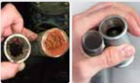
Sistema de tuberías
