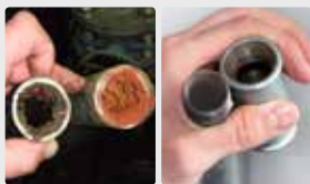
Sistema de tuberías
