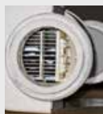
Filtre de piscine
