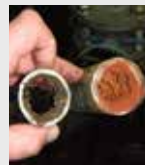
Sistema de tuberías
