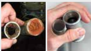
Sistema de tuberías
