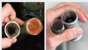
Sistema de tuberías
