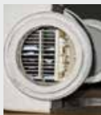
Filtre de piscine
