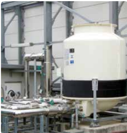
Torre de refrigeración
