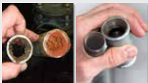
Sistema de tuberías
