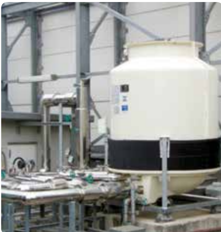
Torre de refrigeración
