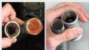
Sistema de tuberías
