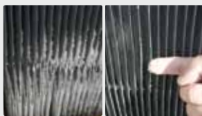
Rejillas de torres de refrigeración
