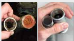
Sistema de tuberías
