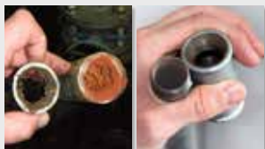
Sistema de tuberías
