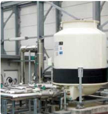
Torre de refrigeración
