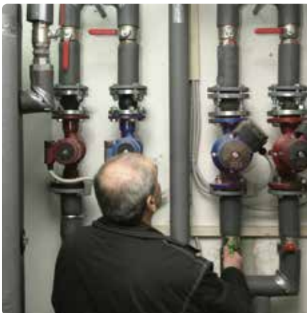
Canalisations dans un immeuble
